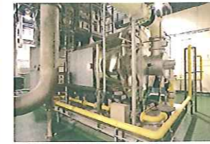
天然ガスを使用する熱風発生炉
